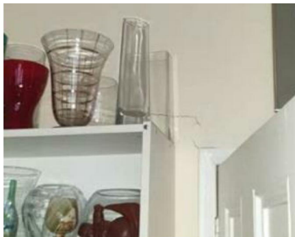
Cracking above door frame.
