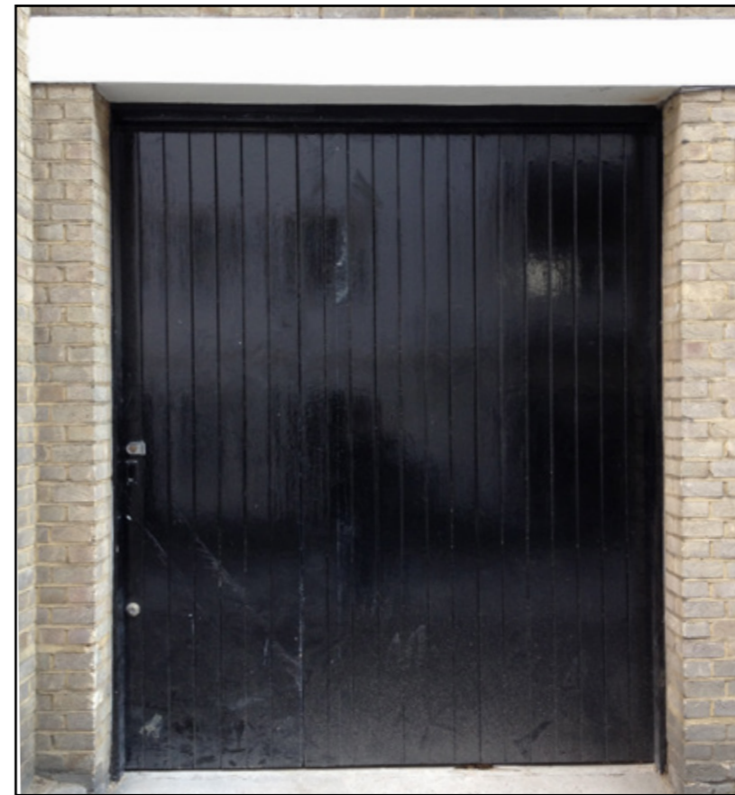
Original Garage Door
