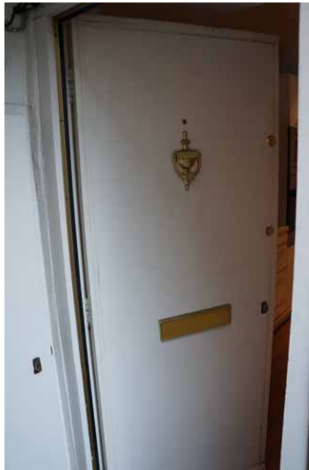
B2. NON-ORIGINAL DOOR
