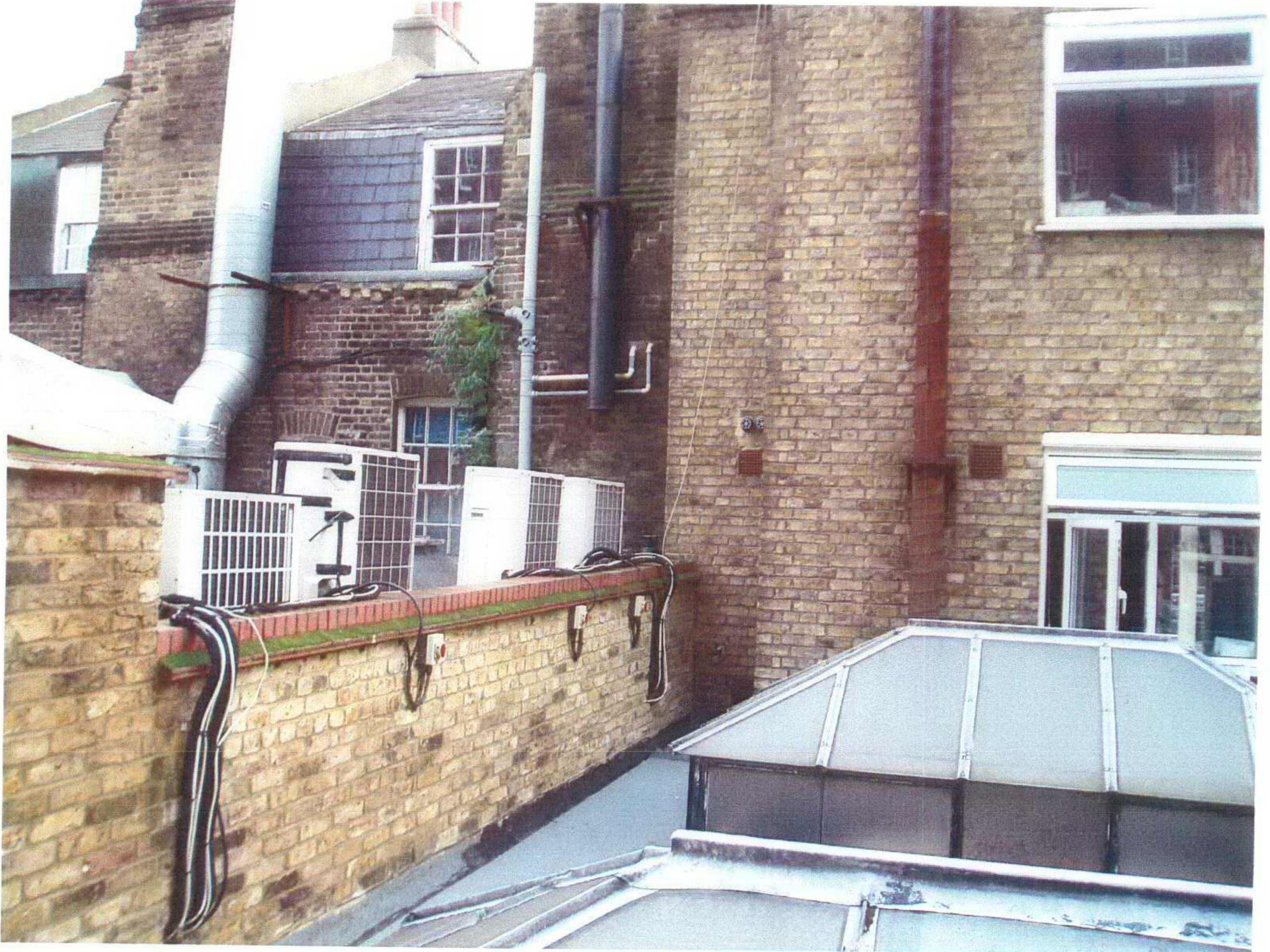
REAR OF N° 16 / N° 18 - 27. INVERTERS STAGE - 11/11
