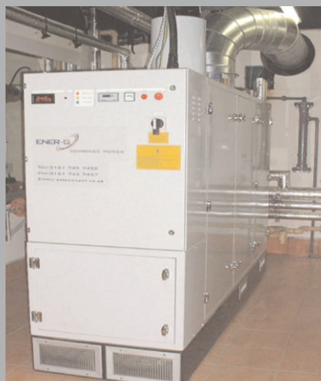
Ener-G CHP unit
