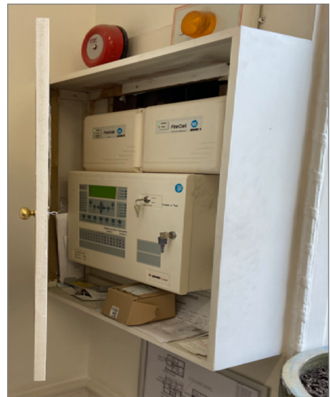
EXISTING FIRE ALARM PANEL SCALE N.T.S.
