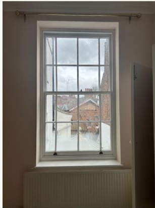
Non original frame, non original glass rotten frame
